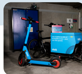
Armoires de recharge pour batteries.
