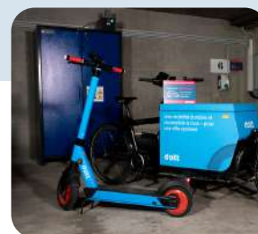
Armoires de recharge pour batteries.
